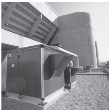
Установка для кондиционирования воздуха
